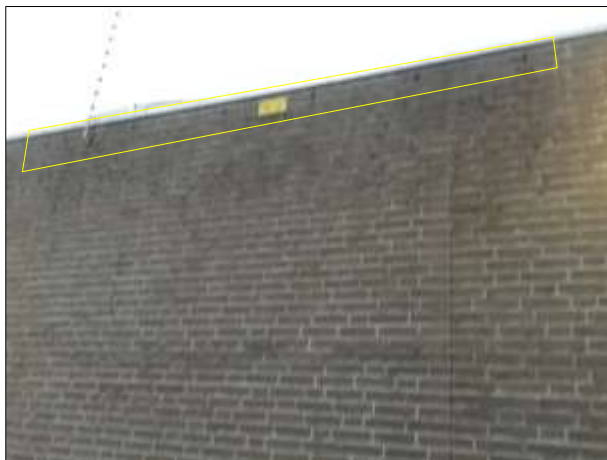
Open stootvoegen in de buitengevel van het voormalig politiebureau. Deze worden in het gele kader aangeduid.
